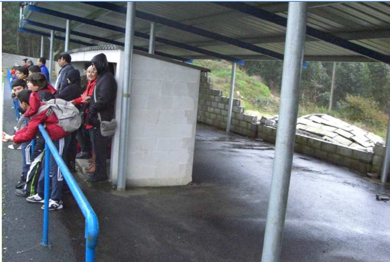
Estado do muro derrubado n'A Fieiteira
